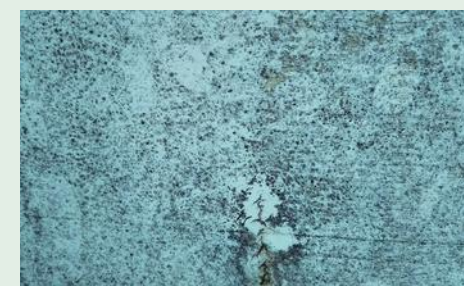
外壁の全面にカビが発生
